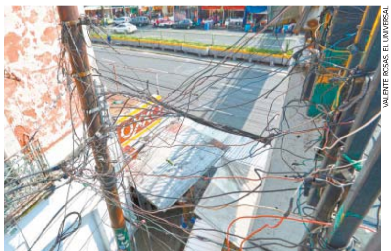
El uso de cables colgados de postes de luz también representa severas pérdidas económicas para la empresa productiva del Estado.
